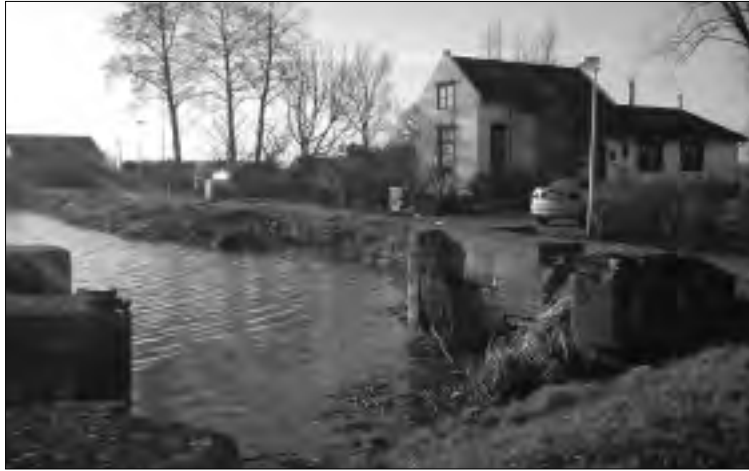
De landhoofden van de vroegere schutsluis tussen de Mallemolen Wijde langs de Moordrechtse Tiendeweg en de ringvaart van de Zuidplaspolder, met op de achtergrond de voormalige sluiswachterswoning uit 1894 (niet de uitbouw, die is van later datum). Foto: auteur.
